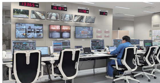
最新の設備で運転を リアルタイムで監視・ 制御する中央制御室
